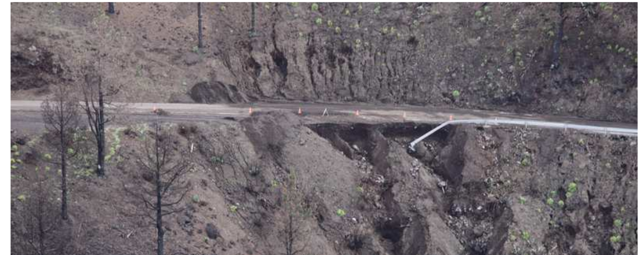
Averías en la LP-2 tras las lluvias de Diciembre de 2009
