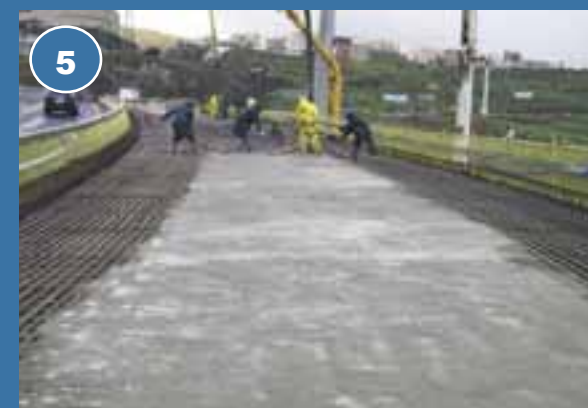
5 Hormigonado de la losa, previa a la colocación de barandillas, aceras y asfaltado del puente
